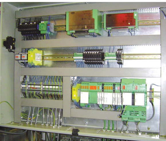
Bild 4. Schaltschrank der Stima-Applikation
